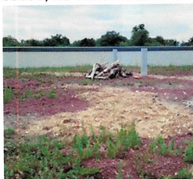
1. Toitures végétalisées type BrownRoofs
