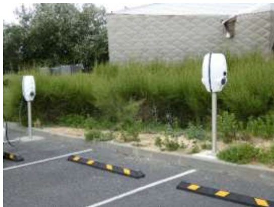
Bornes électriques à Courseulles-sur-Mer (Source : Géostudio)
